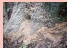
フラス（木くず）の状況 カシノナガキクイムシが穿孔したため
