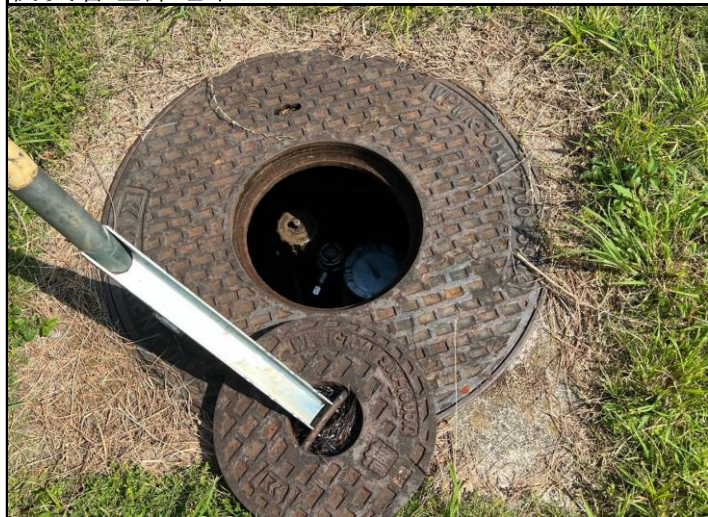
防災管理棟地下タンク
