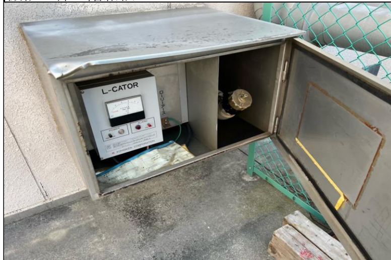
機械室棟 1階給油口
