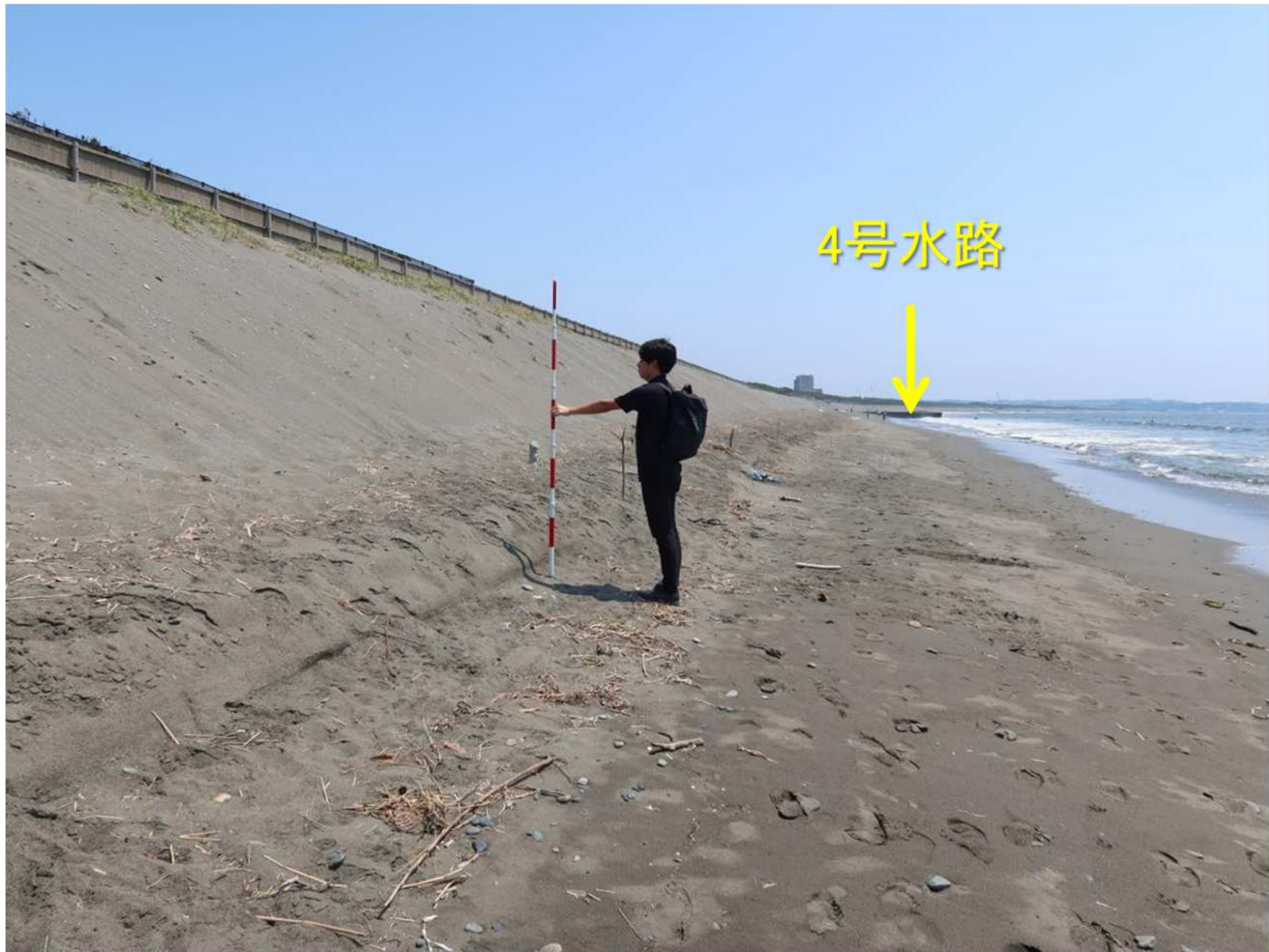
写真-16 いったんは安定化した斜面の下部で始まった小規模な侵食
