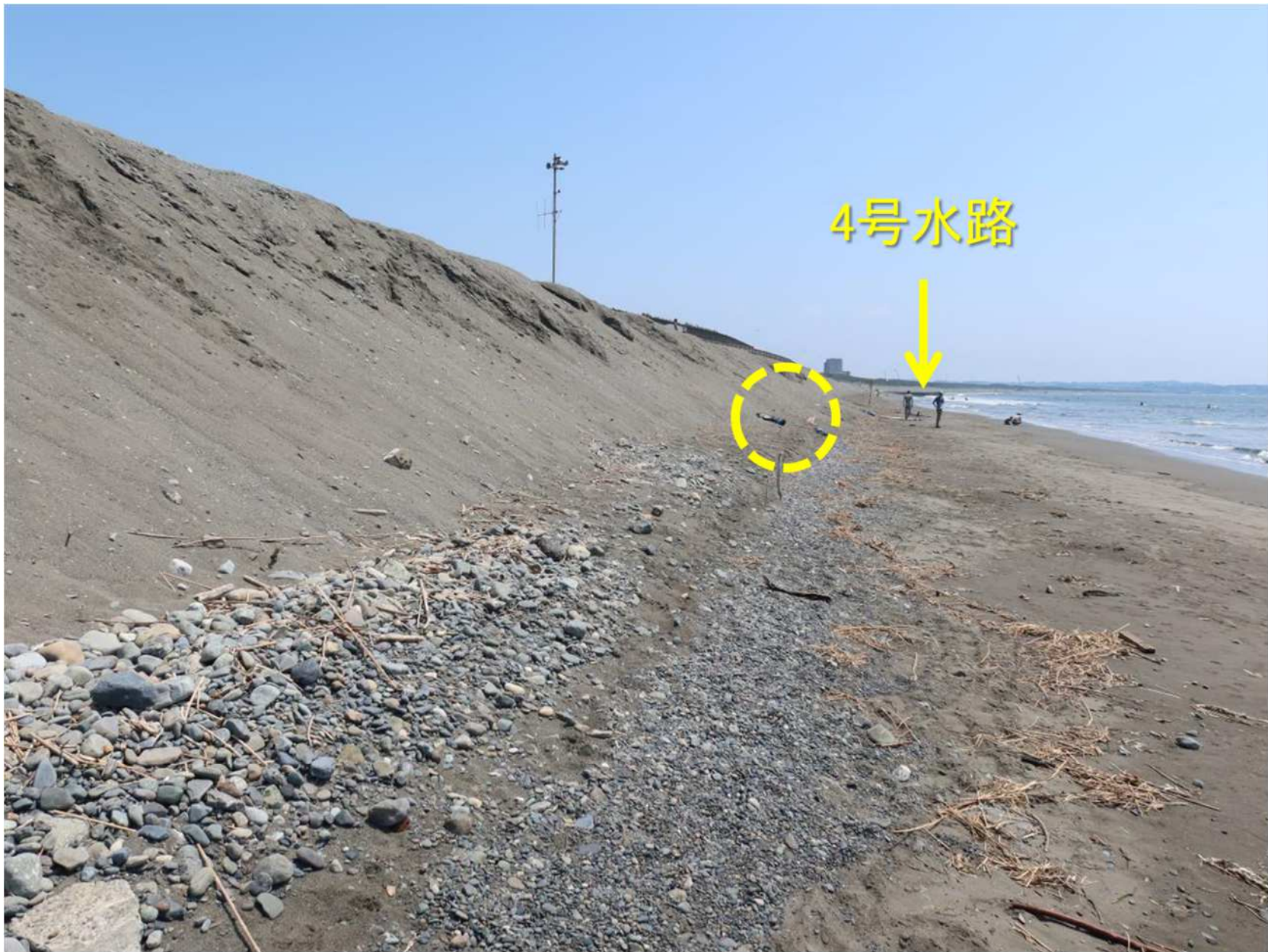
写真-14 浜崖の基部の状況（写真-13に○で示した場所）
