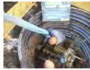
公共下水道の整備
