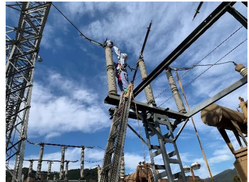
屋外開閉所点検の様子
