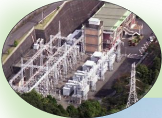
(発電総合制御所)
