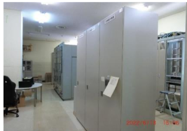
遠隔監視制御装置
