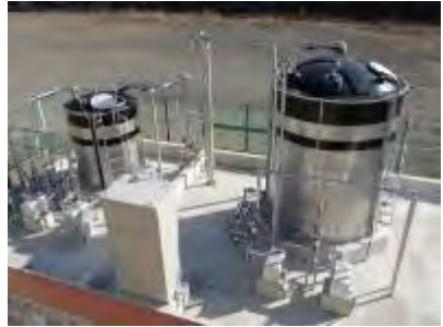
凝集剤添加設備
