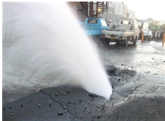
(道路面からの漏水噴出状況)
