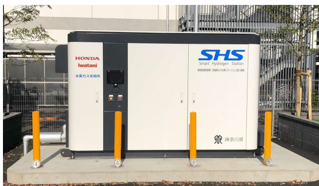
（県再エネ水素ステーション外観）
