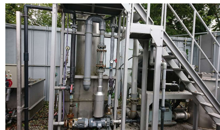
(地下水浄化設備 (秦野市))
