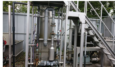
(地下水浄化設備 (秦野市))
