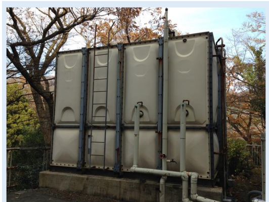
【貯水槽水道(県保健福祉事務所所管域)】
