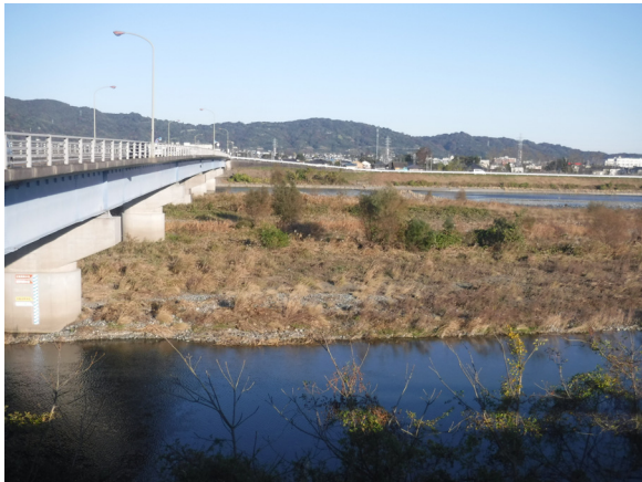
中下流域・土砂堆積状況（5.1km付近）
