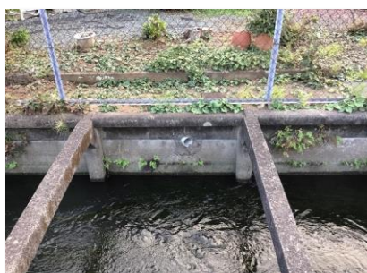
施工前（柵渠の劣化状況）
