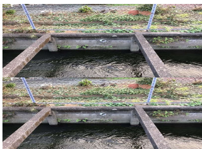
施工前(柵渠の劣化状況)
