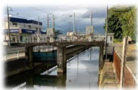
老朽化した水門
