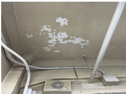
天井塗装の浮き、剥がれ
