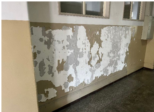
廊下壁塗装の剥がれ
