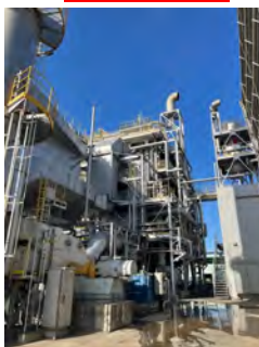
木質バイオマス発電所 （横須賀市）
