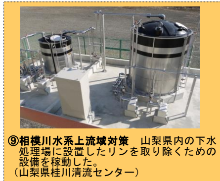
⑨相模川水系上流域対策 山梨県内の下水処理場に設置したリンを取り除くための設備を稼働した。（山梨県桂川清流センター）
