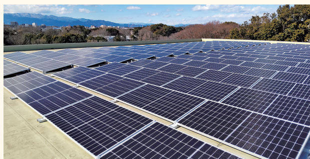
太陽光発電（パルシステム神奈川・大和センター）
