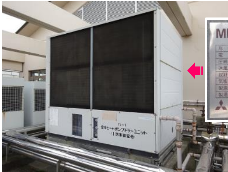
チラー(屋上に設置したケース)
