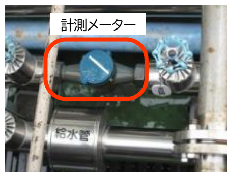
排水管に計測メーターを設置したケース
