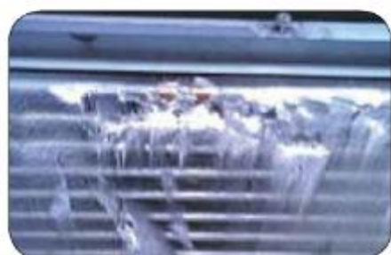
熱交換器表面の損傷
