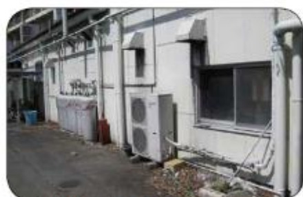
室外環境異常による配管の劣化
