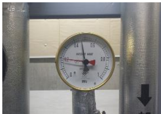
空調機の冷温水圧力計
