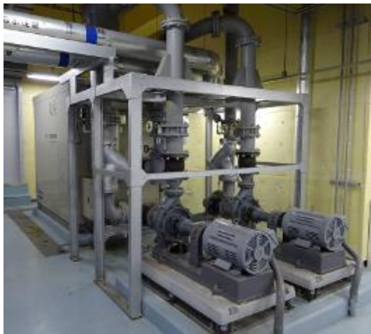
冷温水発生機とポンプ
