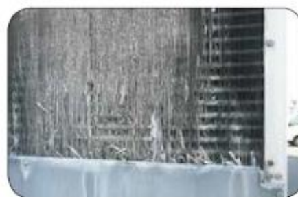
室外機の熱交換器表面の飛散水による腐食
