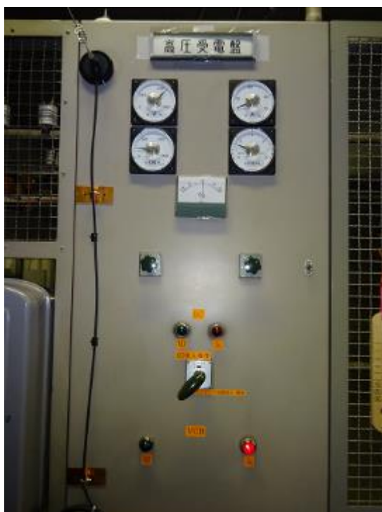
変圧器の操作盤
