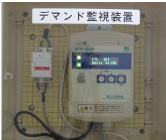
デマンド監視装置(例1)
