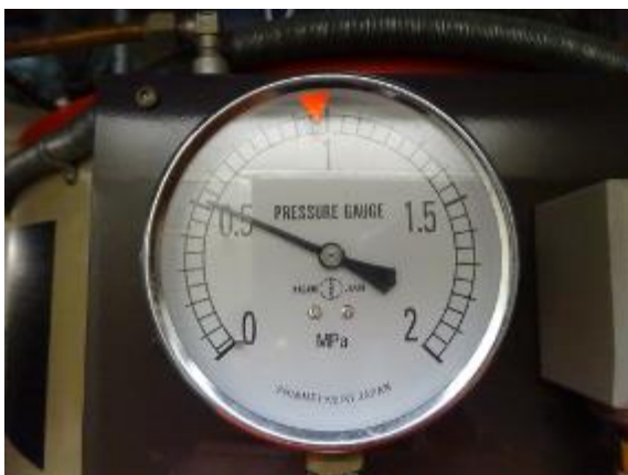
蒸気ボイラーの圧力
