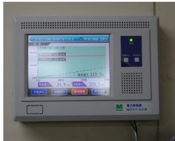
デマンド監視装置(例2)
