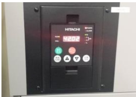
ポンプのインバータ操作パネル
