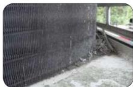
熱交換器下部の腐食
