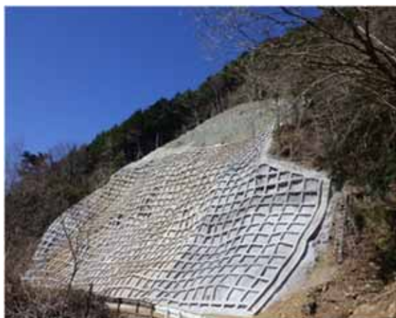
写真2-9 愛甲郡清川村宮ヶ瀬（金沢線）
