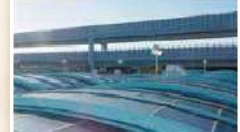
寒川浄水場太陽光パネル
