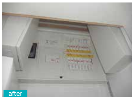
分電盤の両脇に取り付けられたHEMSの計測および送信システム
