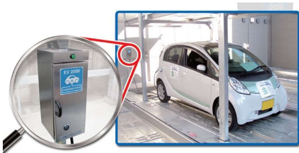
機械式駐車場への充電器設置例 株式会社IHI扶桑エンジニアリングHPより
