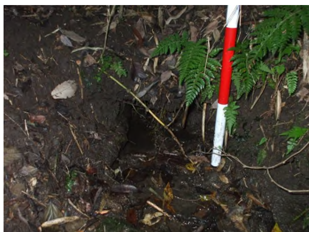
写真-P01 表土から湧水している状況
