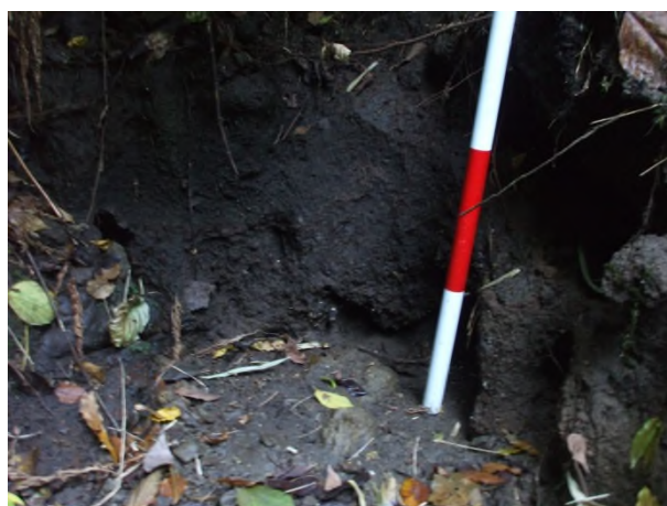
写真-P02 表土からの湧水跡
