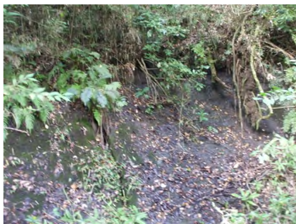
写真-P04 表土の浸み水で岩盤は湿っている
