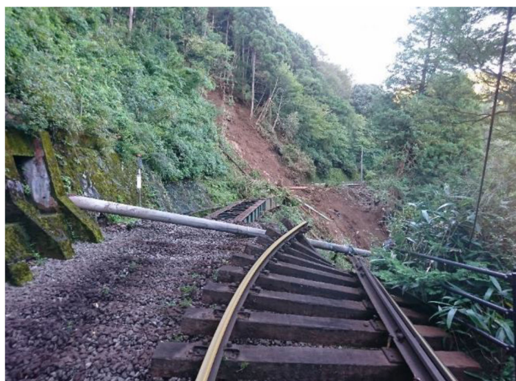
図1-18 2019(令和元)年台風第19号による箱根登山鉄道の被災状況
