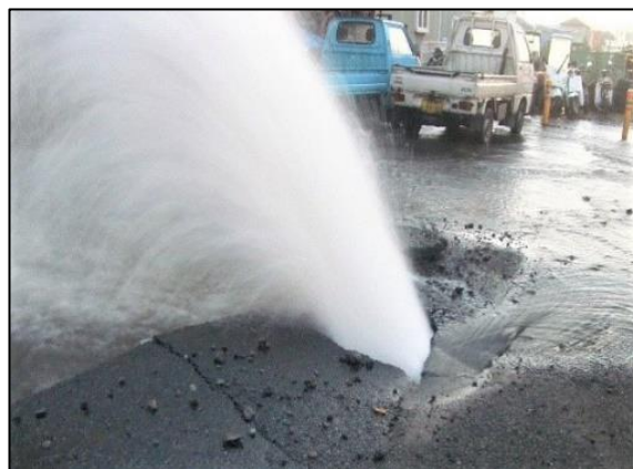
図一 4 漏水事故の発生状況
