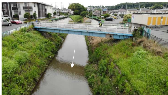
共和橋（未整備箇所 架け替え予定）
