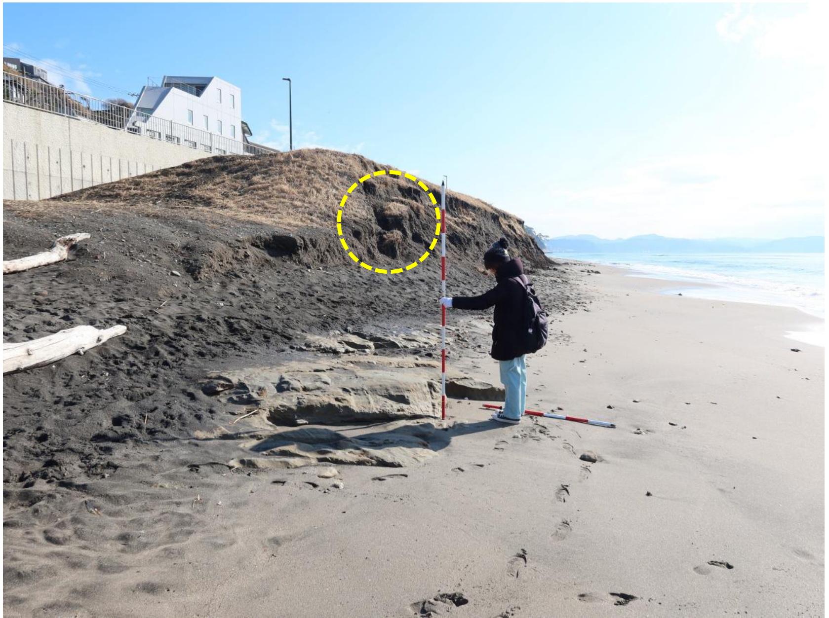
写真-2 盛り土がブロック状に傾いた
