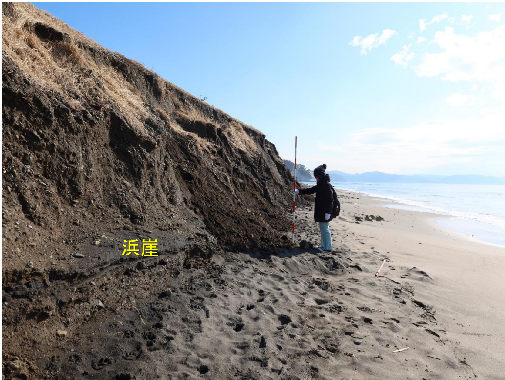
写真-5 東側でも同様な浜崖が残されており，盛り土が不安定となり土砂が落ち込んだ
