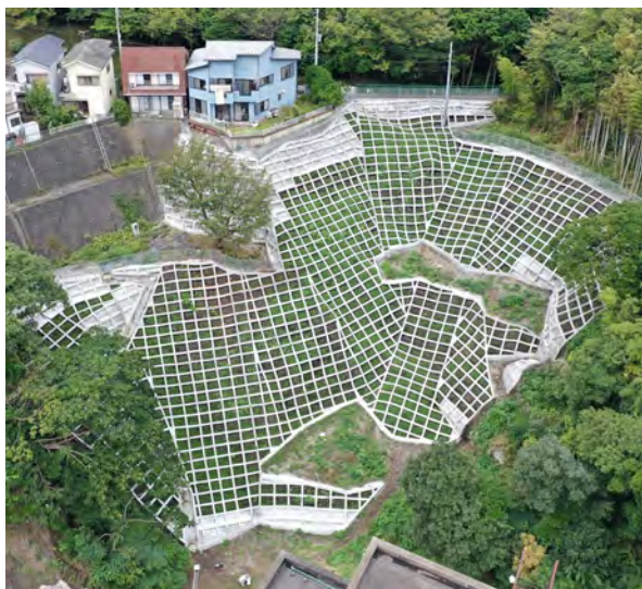
写真: 住宅地に近接したがけ崩れ防止施設
