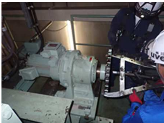
機械設備の点検の様子
