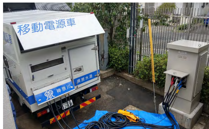
移動電源車に対応した設備
