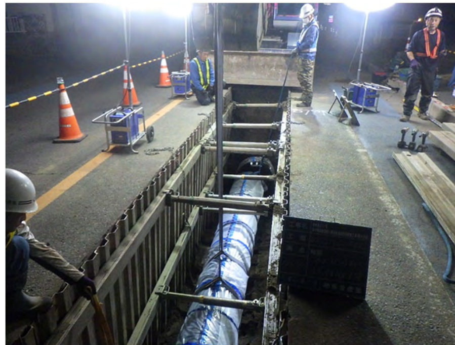
茅ヶ崎市赤羽根～東海岸基幹管路更新工事 埋設工の様子
