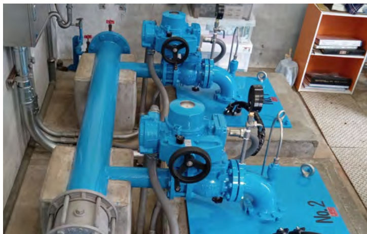
ポンプ設備（善波揚水ポンプ所）
