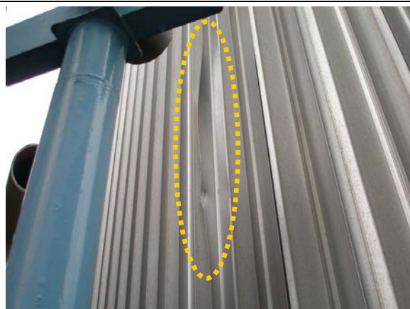
図2 蒸発器フィンの破損状況
