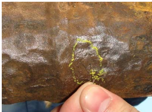
図4 導管下面の孔食の様子
