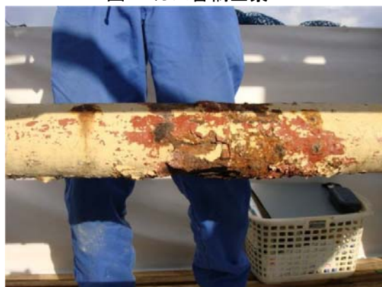
図3 漏えい箇所付近の様子
