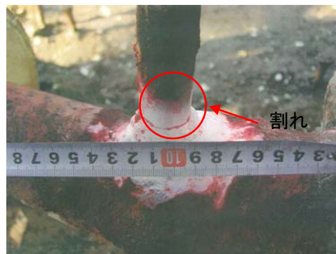
図4 ノズル溶接部(割れ発生)
