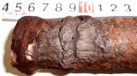
図2 配管の腐食状況
