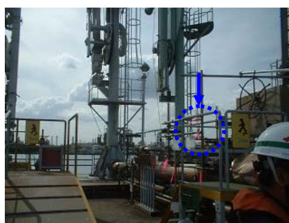
図1 棧橋外観 (写真右手奥が漏えい箇所)
