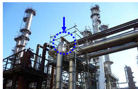
図3 配管外観 (写真中央部が漏えい箇所)
