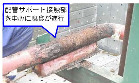
↑ 図6 配管サポート部
