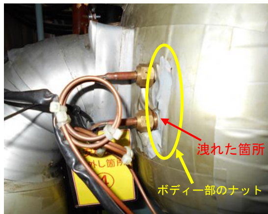
低圧側のチェックジョイントはボディーのナットが保温材で覆われている
