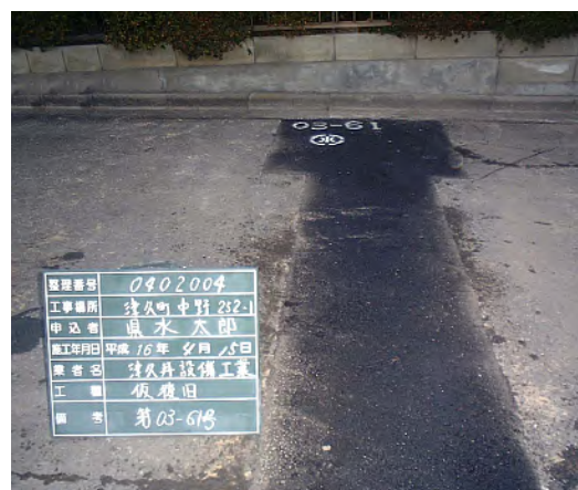
⑫ 仮復旧工 ⑳マーク及び掘削占用許可番号の表示、周囲の路面状況が分かるように撮影する
