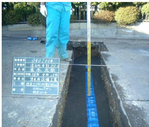
⑨ 埋戻工 (明示シート布設) 転圧の施工中、施工後の状況を各層毎に撮影し、スタッフ等で深さが分かるように撮影する。
