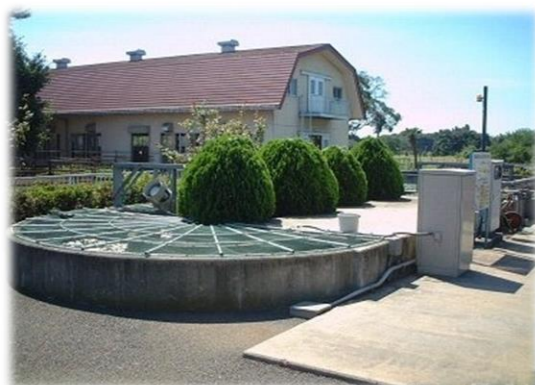
家畜用浄化槽
