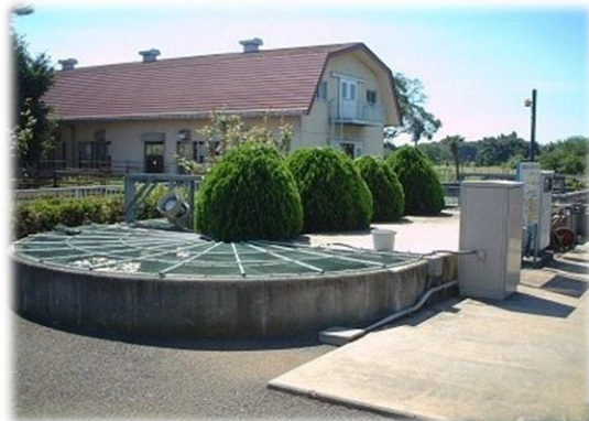
家畜用浄化槽
