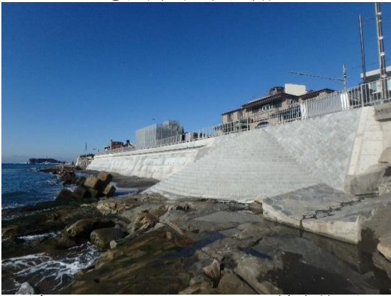
（令和元年 台風10、19号の被害箇所）
