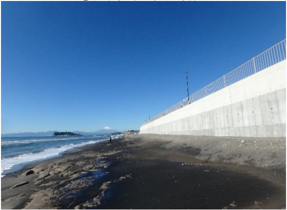
（平成29年 台風21号の被害箇所）
