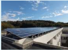
横浜栄高等学校に設置した太陽光発電設備
