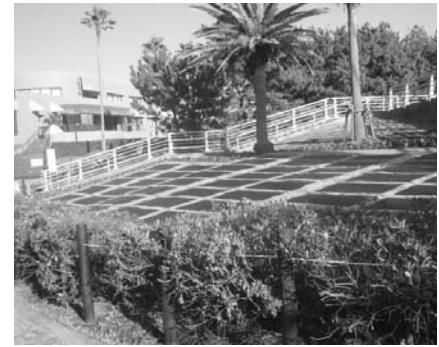
道路法面に設置した薄膜太陽電池
