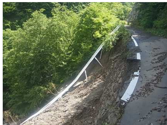
【豪雨による道路陥没箇所】
