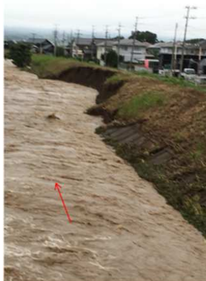
③ 被災状況(H29.7.24)
