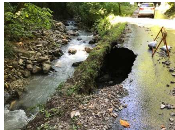
【豪雨による道路陥没箇所】
