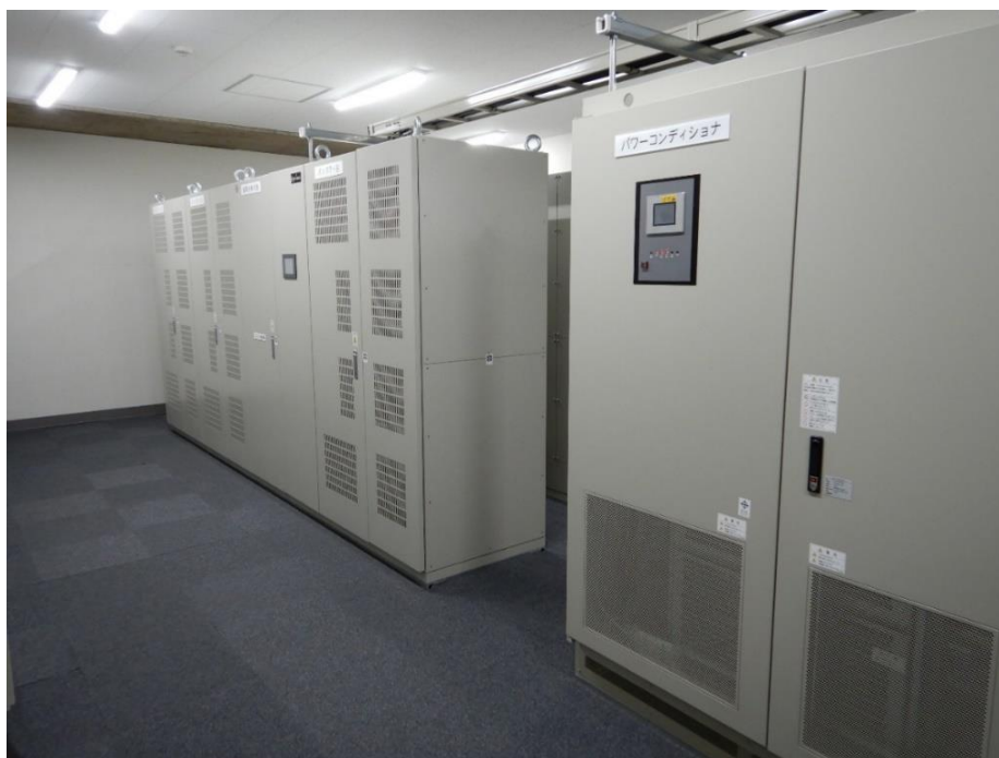
機械室に設置されていた蓄電池
