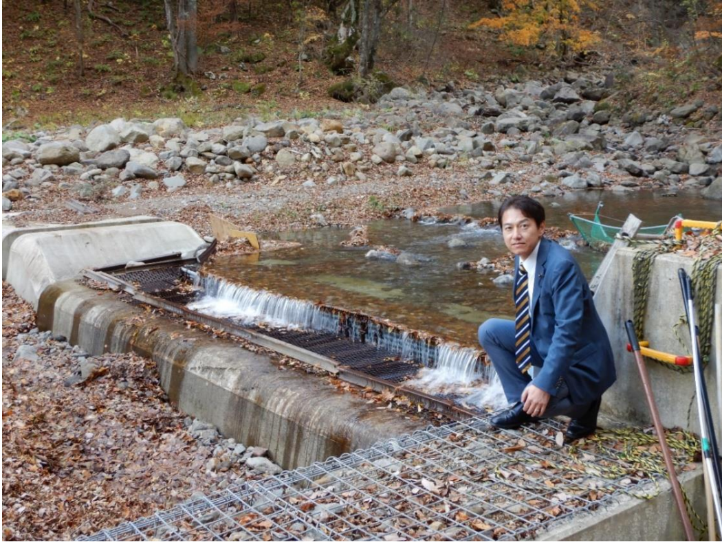
取水口。朝、夕とごみの除去を行っている。
