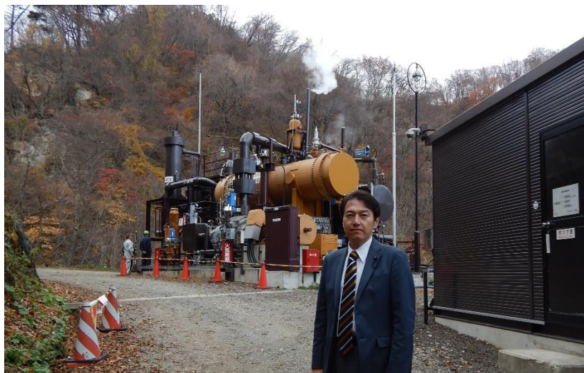
バイナリー発電の全景。コンパクトで音も静か。
