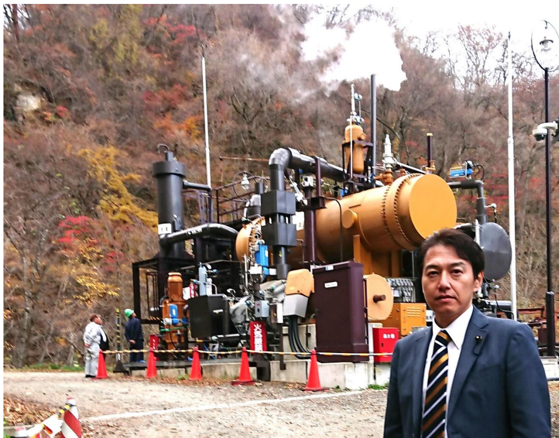
福島県福島市土湯温泉のバイナリー発電所にて 古賀照基県議会議員
