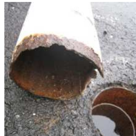
ポール看板の倒壊
