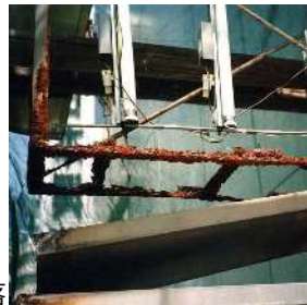
袖看板の底部脱落
