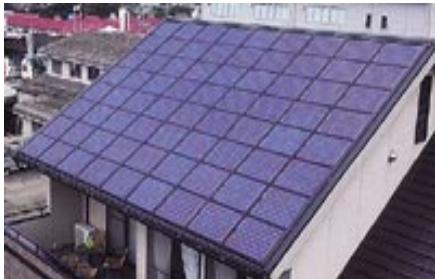
写真 太陽光発電システム外観(京セラ製)
