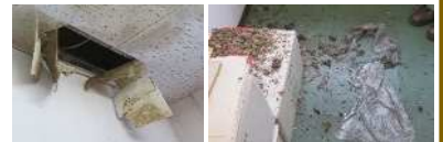
糞尿で天井が抜け落ちる被害
